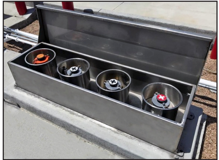
A1005-764-2001 Remote Fill Vault 3 Fill + Vapor
